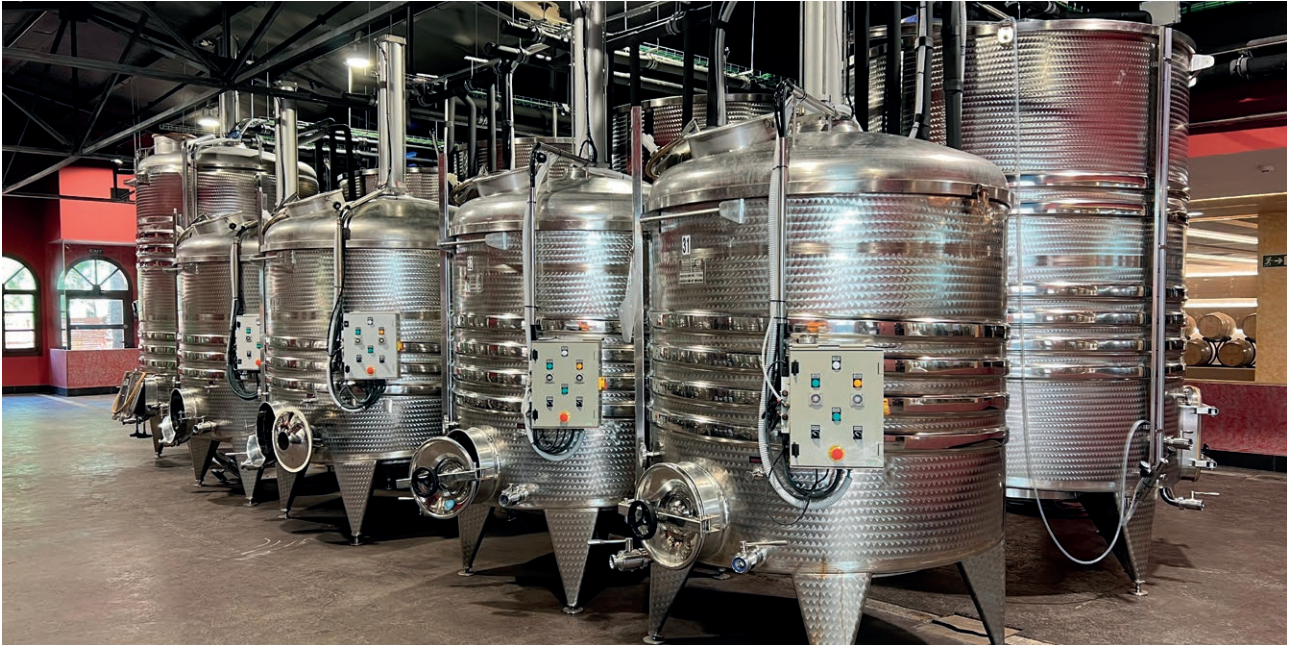
Blanca Terra, Mallorca. Depósitos simple llenos FISP con puerta y camisa con opción Pigeage. Proyecto especial.
